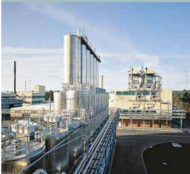
В нефтехимии бесперебойное распределение электроэнергии обеспечивает система LR.
