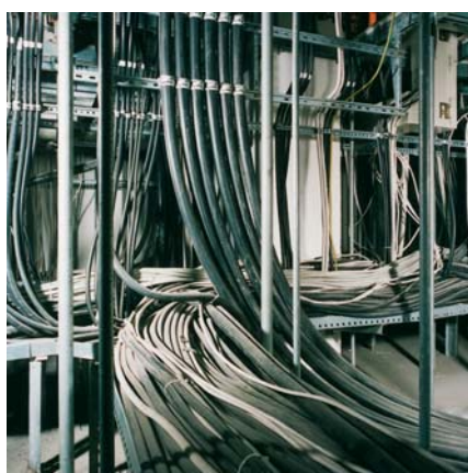
Высокая пожарная нагрузка с кабелями
