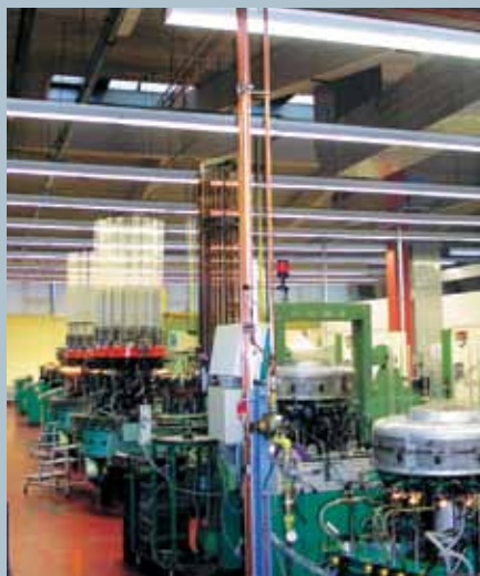
Новое энергоснабжение упаковочной линии
